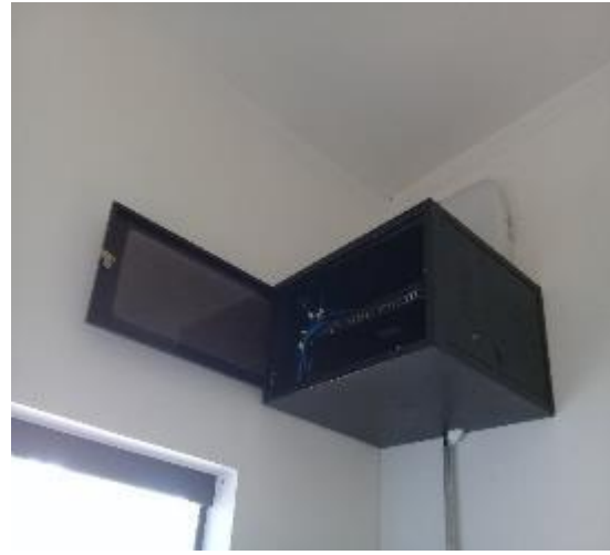
Rack metálico para informática
