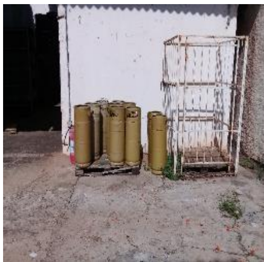
Tanques de gás
