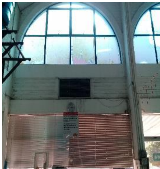
Climatizador salão grande
