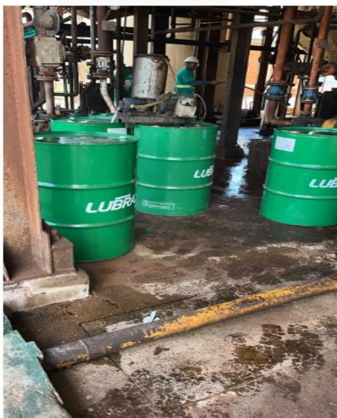
Óleo mineral para abastecer sistema de absorção da extração
