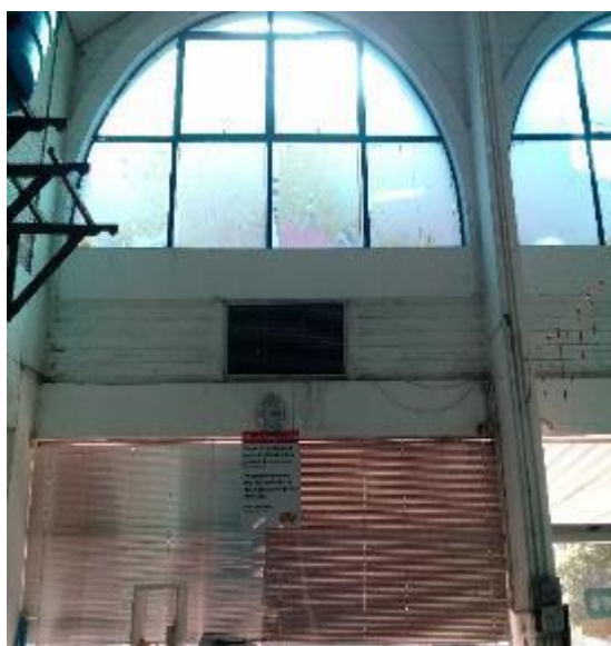
Climatizador salão grande
