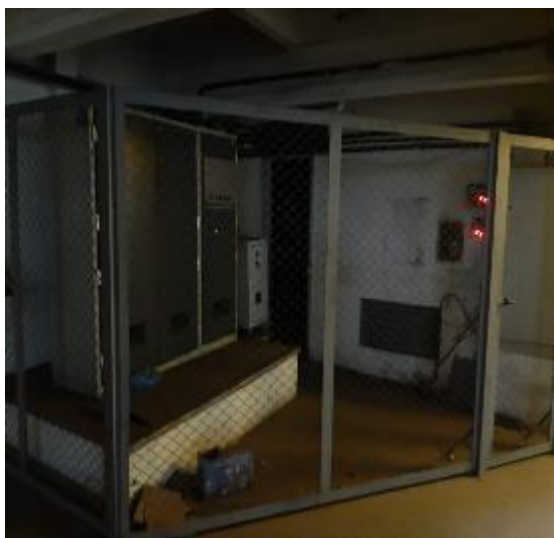
Cabine primária com transformador
