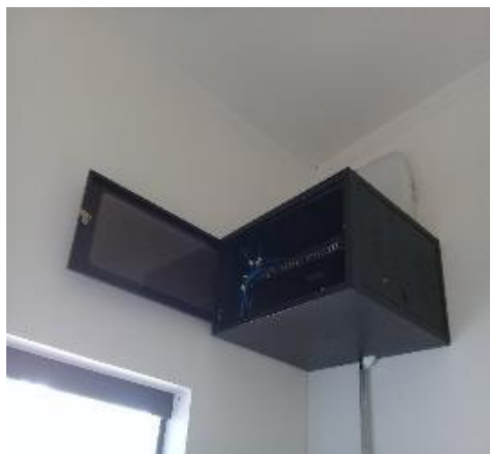
Rack metálico para informática
